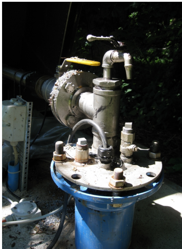
Der er drysset flamingo ned på boringen, hvilket tyder på at dyr gnaver i flamingoen.
