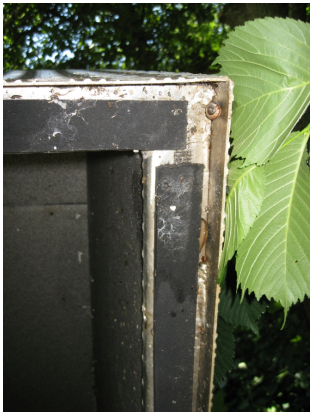
Listen slutter ikke tæt, hvilket giver adgang for smådyr til råvandsstationen. Den bør skiftes/tættes.
